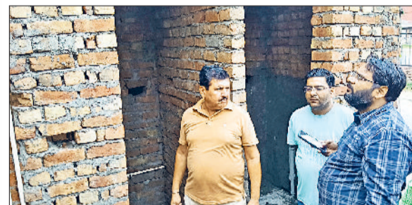
मिवाणी। निर्माणाधीन सार्वजनिक शौचालय का निरीक्षण करते नप चेयरपर्सन प्रतिनिधि भवानी प्रताप सिंह व हांसी गेट अशोका रोड पर निर्माणाधीन सार्वजनिक शौचालय।
